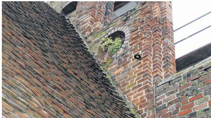
Das Dach ist stark sanierungsbedürftig – was nicht nur an den schon aus Nischen wachsenden Bäumchen zu sehen ist.
