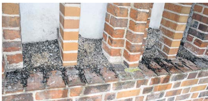
Taubenkot türmt sich in den Mauernischen. Der setzt dem Mauerwerk stark zu.
