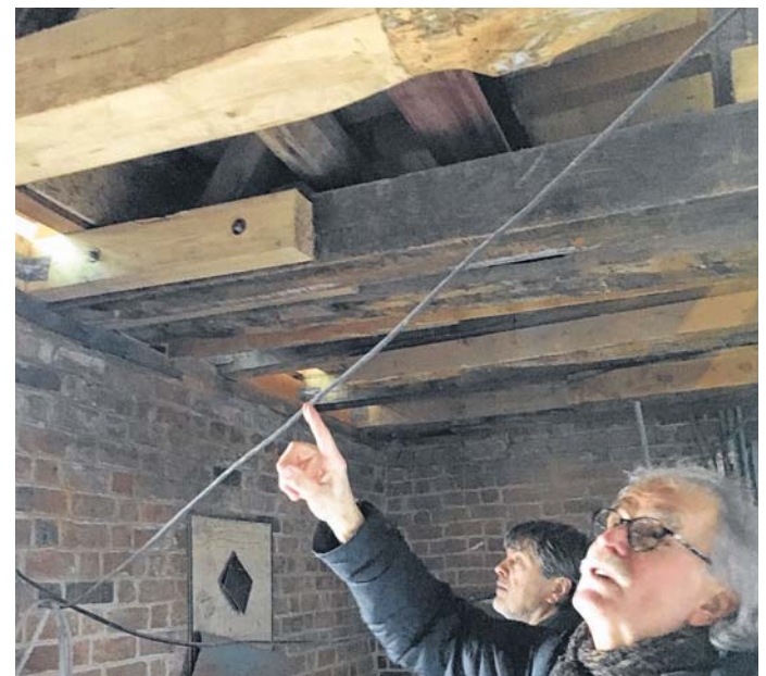
Projektleiter Torsten Eilrich (hinten) und Planer Gunter Bernhardt begutachten die verschiedenen Reparaturtechniken.
