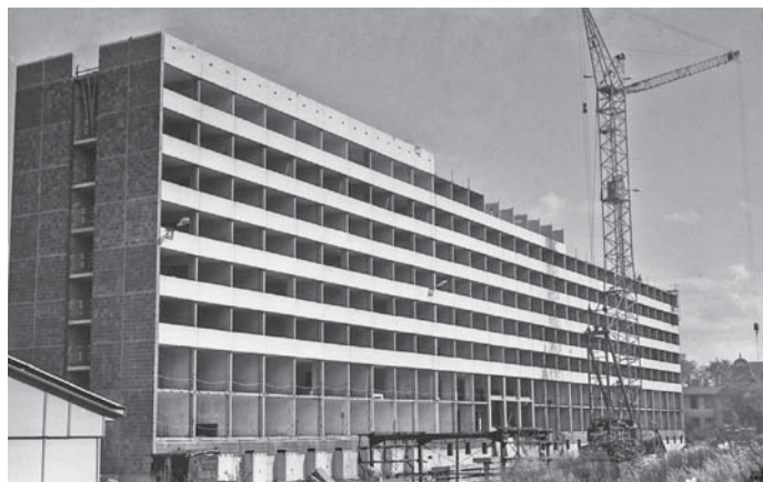
Stand der Montagearbeiten am Bezirksgebäude, dem heutigen Rathaus, im Juli 1968 FOTO: HORST BEYERMANN
